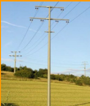
Masthöhe ca. 10-16m 20 kV-Doppelleitung
