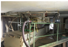
Einbringöffnung am Silotrichter
