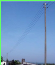
Masthöhe ca. 8-12m Niederspannungsfreileitung
